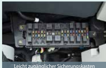
Leicht zugänglicher Sicherungskasten
