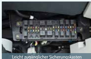
Leicht zugänglicher Sicherungskasten
